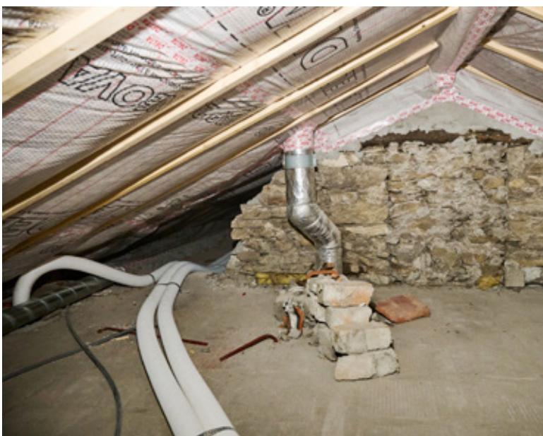
Vue dans la chape: les tuyaux de ventilation gris clair atteignent toutes les pièces du bâtiment.
